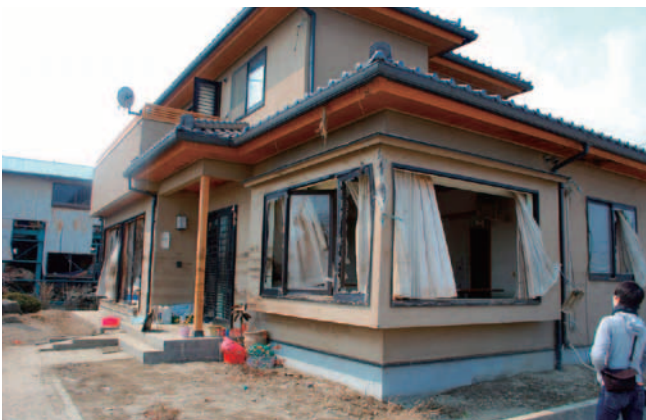
写真6 東日本大震災被害状況（その2）
