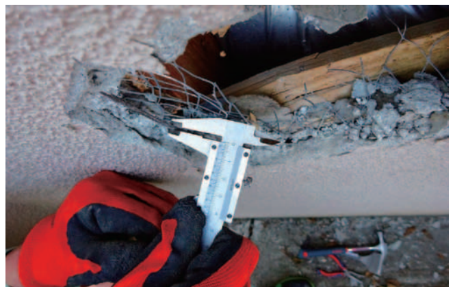
写真10 熊本地震被害状況（その4）
