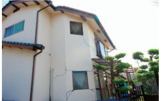
写真7 熊本地震被害状況（その1）
