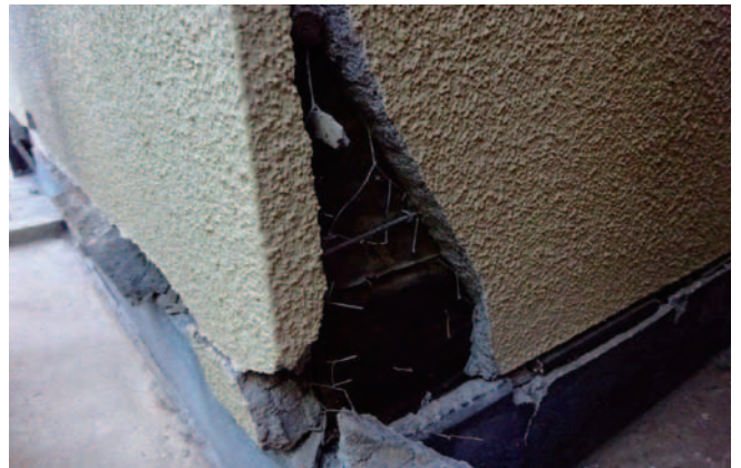
写真9 熊本地震被害状況（その3）
