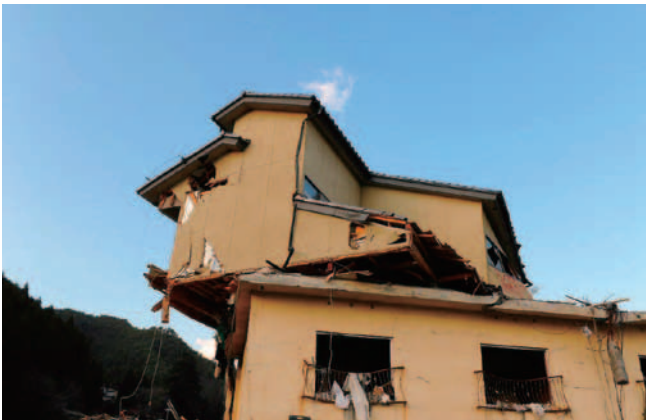
写真5 東日本大震災被害状況（その1）
